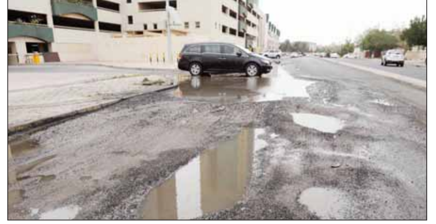
● الحفر تملأ الطريق
