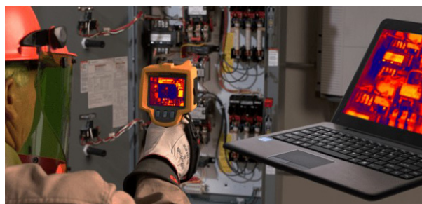
Рис. 1 Проведение тепловизионного контроля электрошкафа
