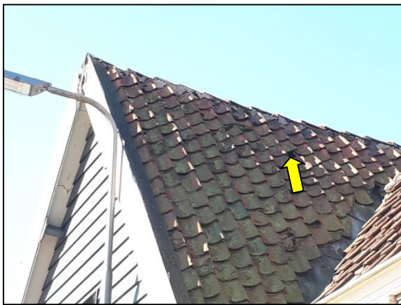
Figuur 9. Ruimte tussen dakpannen geschikt als invliegopening voor gierzwaluw.
