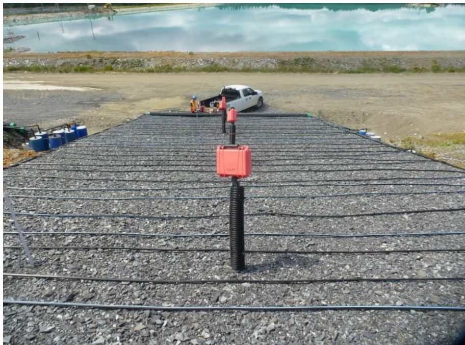
Figure 3.11 Système d'irrigation avec tuyaux à goutteurs intégrés installés sur la cellule inclinée
