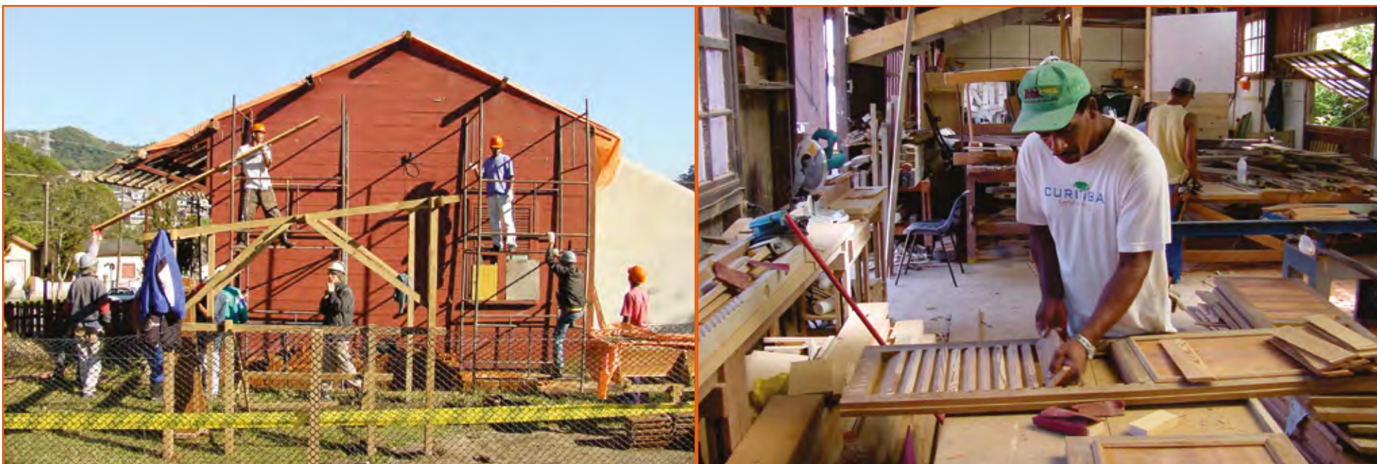
Coopérative de charpenterie/ébénisterie. Locaux des bancs et matériaux. Restauration des maisons de type E-CDARQ
