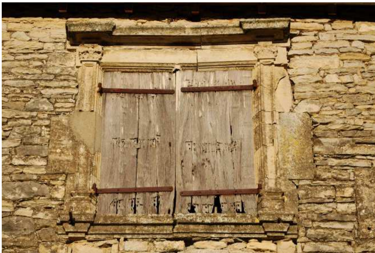
Fig. 27 : Maison de Gradels à Valady, élévation sud, 2 e étage, détail de la croisée (cliché Julie Lourgant, 2009).
