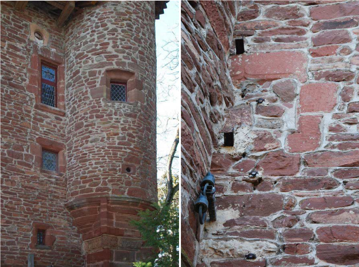
Fig. 15 : Façade nord-est, détail ; Fig. 16 : façade nord-est, détail de la fenêtre en accolade bouchée.
