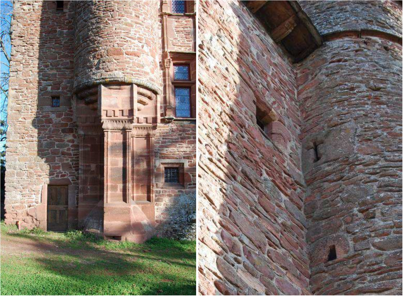
Fig. 38 : Façade sud-ouest, base de l'échauguette ; Fig. 39 : Fentes de tir percées dans l'échauguette occidentale.
