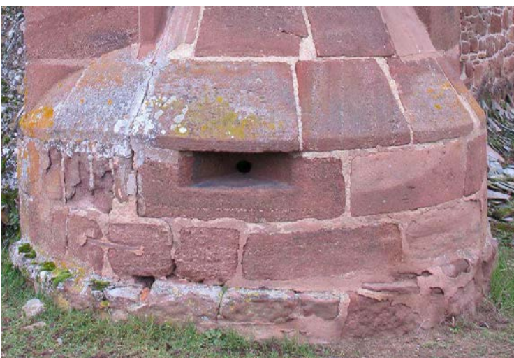
Fig. 32 : Base de l'échauguette est, détail d'une canonnière.
