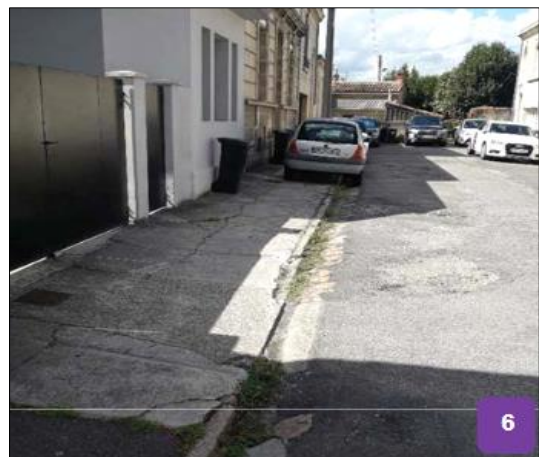
Vue de l'état de la chaussée et du trottoir
