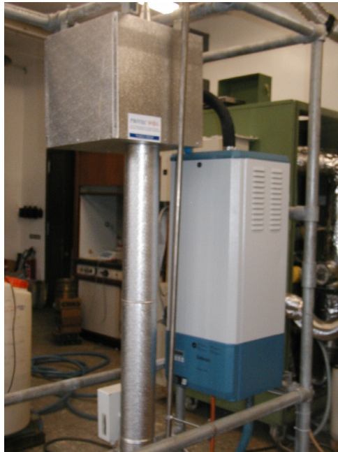
Figure III.9 : Vue du générateur de vapeur et du caisson d'injection cubique.
