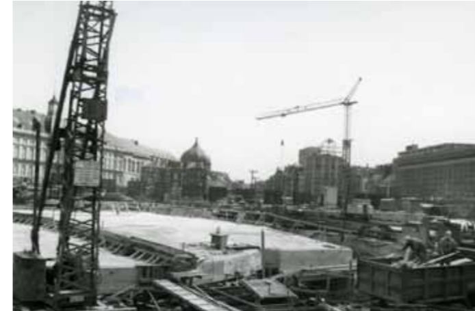
Fig. 2 Vue générale de la place Saint-Lambert en chantier, Liège, 1979. © Cliché Jean Francotte. Centre d'Archives et de Documentation de la CRMSF à Liège - fonds de la Ville de Liège.
