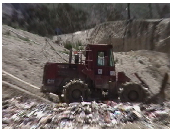
Maquinaria pesada en el deposito de basura
