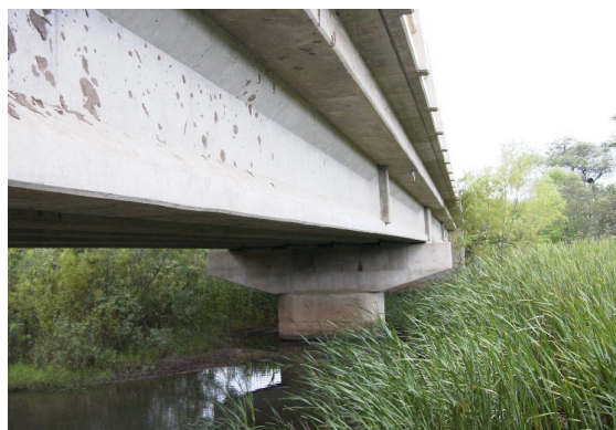
Sitio de Construcción 3 (Puente Las Malas, las marcas de inundaciones son menores que el HWL planeado y no tiene problemas)
