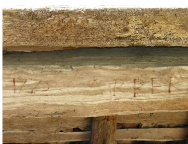
Bâtiment sud : poutre de l'extension de 1775 portant l'inscription « 1775 CARPERI ». Phot. Gaëlle Prost IVC32208_20103200556NUCA
