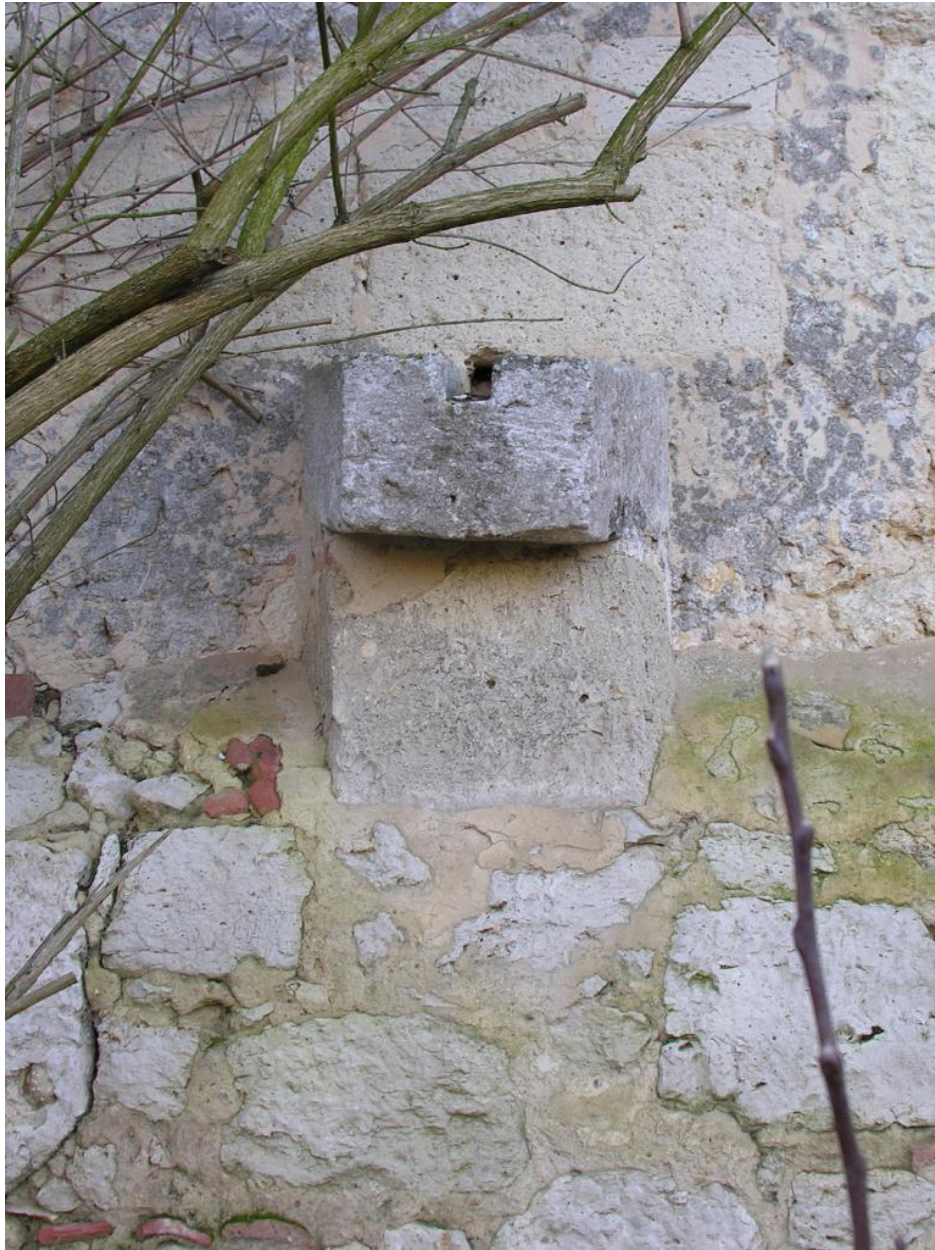
Bâtiment sud : écoulement de l'évier de l'étage.
