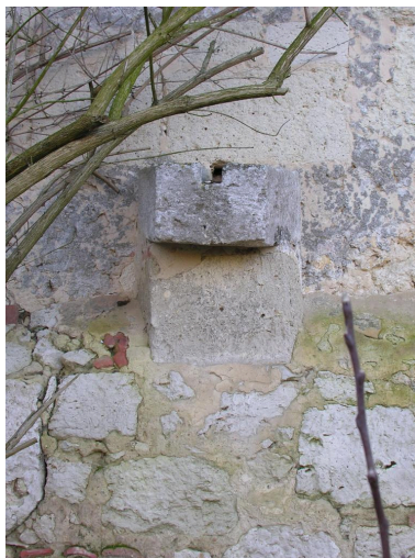
Bâtiment sud : écoulement de l'évier de l'étage. Phot. Gaëlle Prost IVC32208_20103200540NUCA
