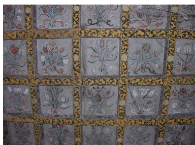
Logis : plafond peint de la tour d'angle nord-est. Phot. Gaëlle Prost IVC32208_20103200536NUCA
