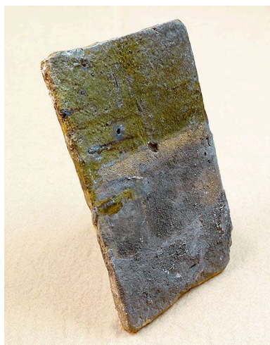
Tuile vernissée provenant du bras nord du transept de la cathédrale, et déposée dans le second niveau de caves du musée Bossuet. Cette tuile fait partie d'un ensemble remontant au Moyen Âge. Phot. Jean-Bernard Vialles IVR11_20127700948NUC4A
