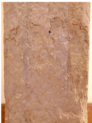
La salle basse occidentale : détail d'un pilier, montrant l'érosion de la pierre. Phot. Stéphane Asseline IVR11_20087700183NUC4A
