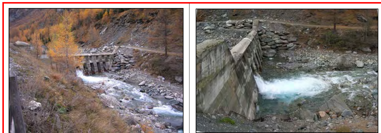
Fig. 3.35 - Stato attuale della briglia n. 1, con visione di insieme a sinistra ed esame in particolare a destra.
