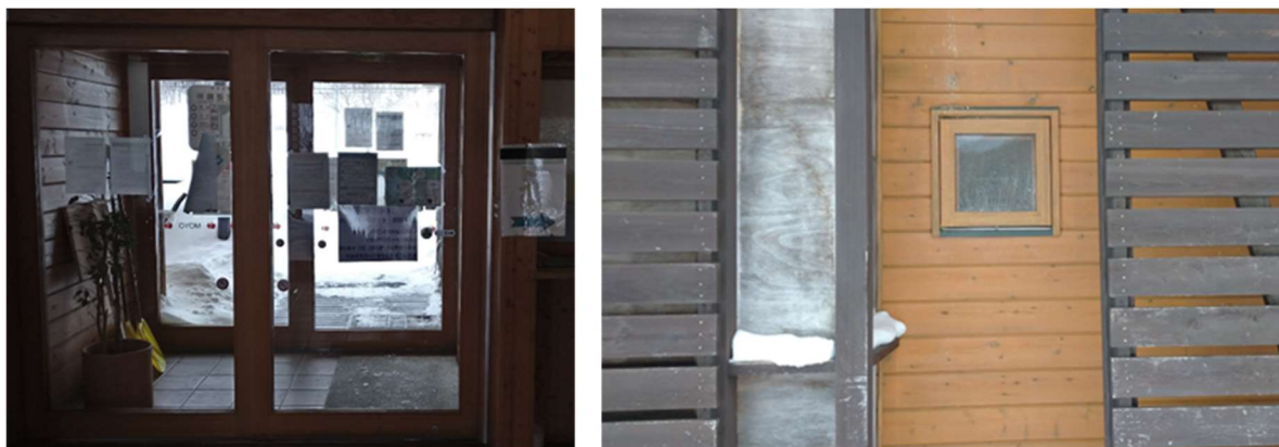
図 3.3.32 公共施設研修室 寒冷地仕様の風除室と凍害防止壁
