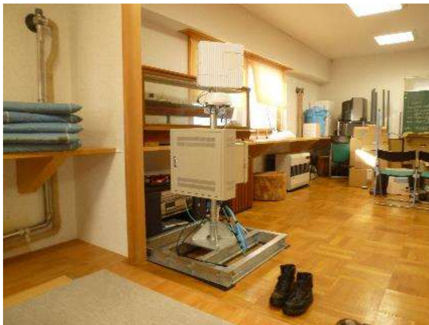
図 3.3.5 公共施設(毛陽交流センター)内研修室 実証環境 基地局設置位置
