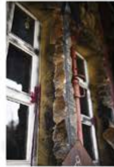
Brisures des angles vifs Breaking of sharp angles
