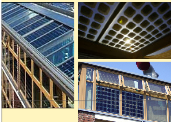
1. Panneaux solaires toiture, façades.
