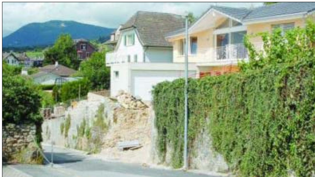
ROCHETTES 15 Les travaux qui ont soulevé une polémique sont en phase d'être terminés. (RICHARD LEUENBERGER)
