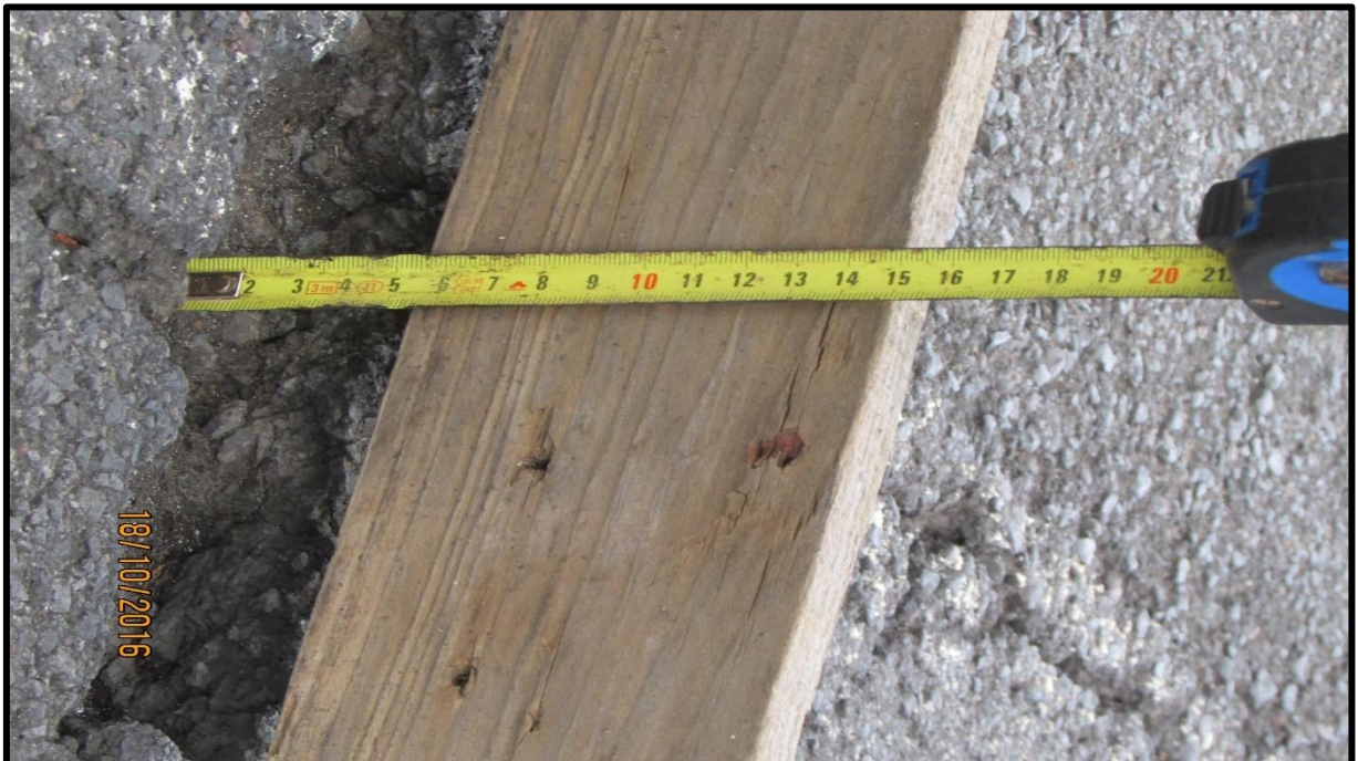
Figura 65 – Ninhos – Grau de severidade alto (pk ≈ 0+140)
