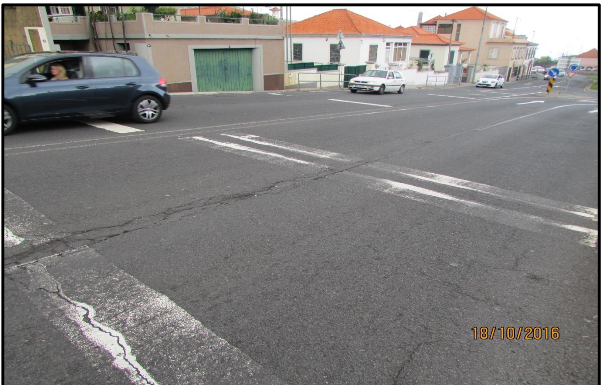
Figura 72 – Fissuras longitudinais -Grau de severidade médio (pk \approx 0+30)
