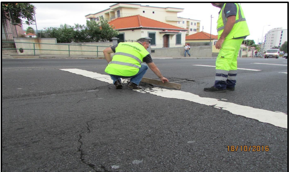
Figura 64 – Pele de crocodilo e depressão – Grau de severidade alto (pk \approx 0+140)
