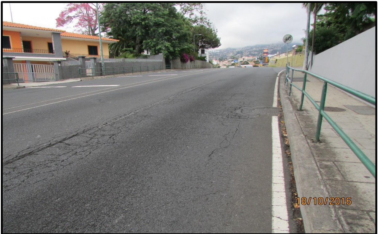
Figura 83 – Fissuras longitudinais evoluídas em pele de crocodilo – Grau de severidade alto (pk \approx 0+100)
