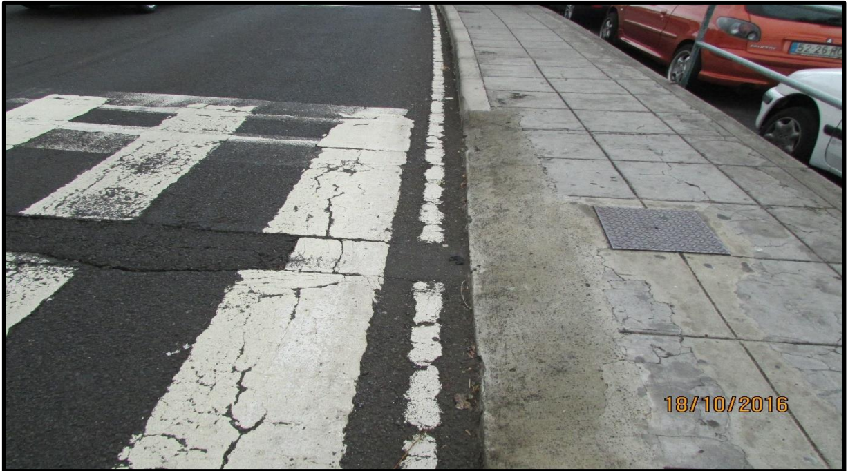
Figura 69 – Fissuras transversais evoluindo para pele de crocodilo – Grau de severidade baixo (pk ≈ 0+60)
