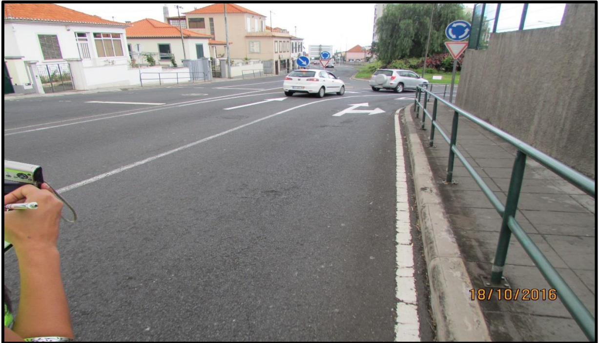
Figura 73 – Desagregações superficiais – Grau de severidade baixo (pk ≈ 0+20)
