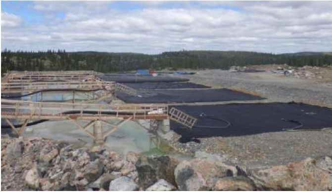
Photo 3.32 Usine de traitement modulaire avec sacs filtrants nommés Geotube®
