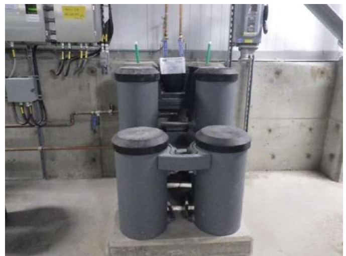
Photo 3.34 Séparateur des condensats de la remontée d'air frais (FAR)
