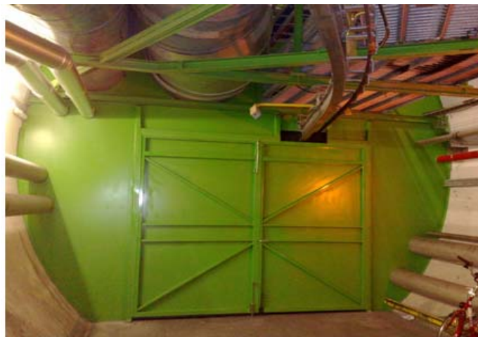
Fig. E3: Picture of the UL44 door
