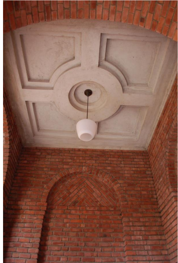
Opprinnelige pendellamper – skadete supplert i 2011
