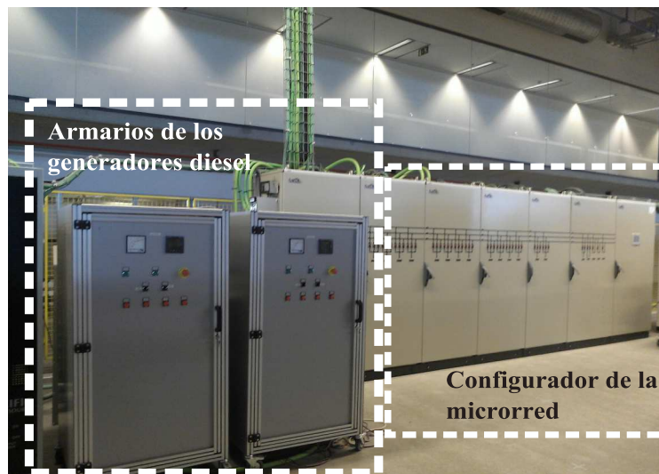
Figura 5.3: Armarios de control de los generadores diesel y el configurador de la microrred de TECNALIA.
