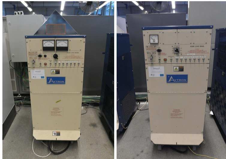
(a) Cargas AVTRON Millennium. (b) Cargas reactivas AVTRON K595.
