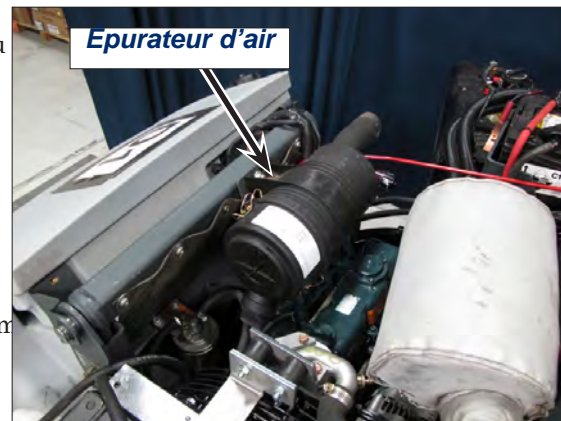
Sommet du compartiment du moteur avec des couvercles supérieurs enlevés
