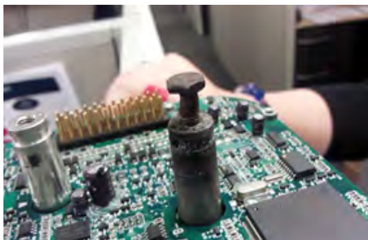
Borne d'organe de commande de traction endommagée par une connexion desserrée. (Carter enlevé pour plus de clarté)
