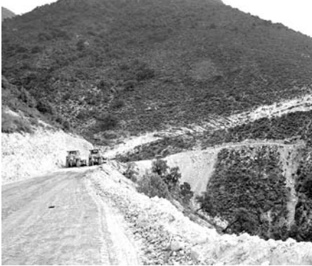
Abb. 2 Baumaßnahmen, die das Habitat der Mammillaria herrerae Werderm. beeinflussen).
