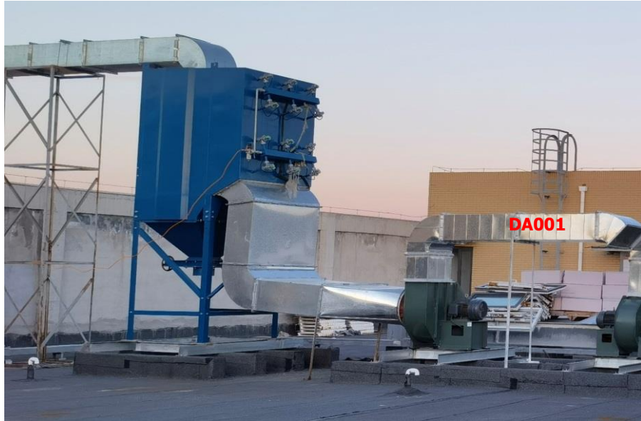
图3-2除尘器及排气口
