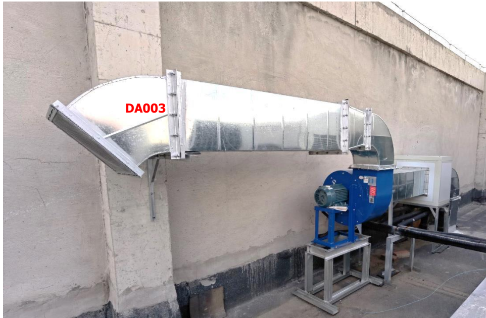
图3-6 污水站废气净化装置及排气口
