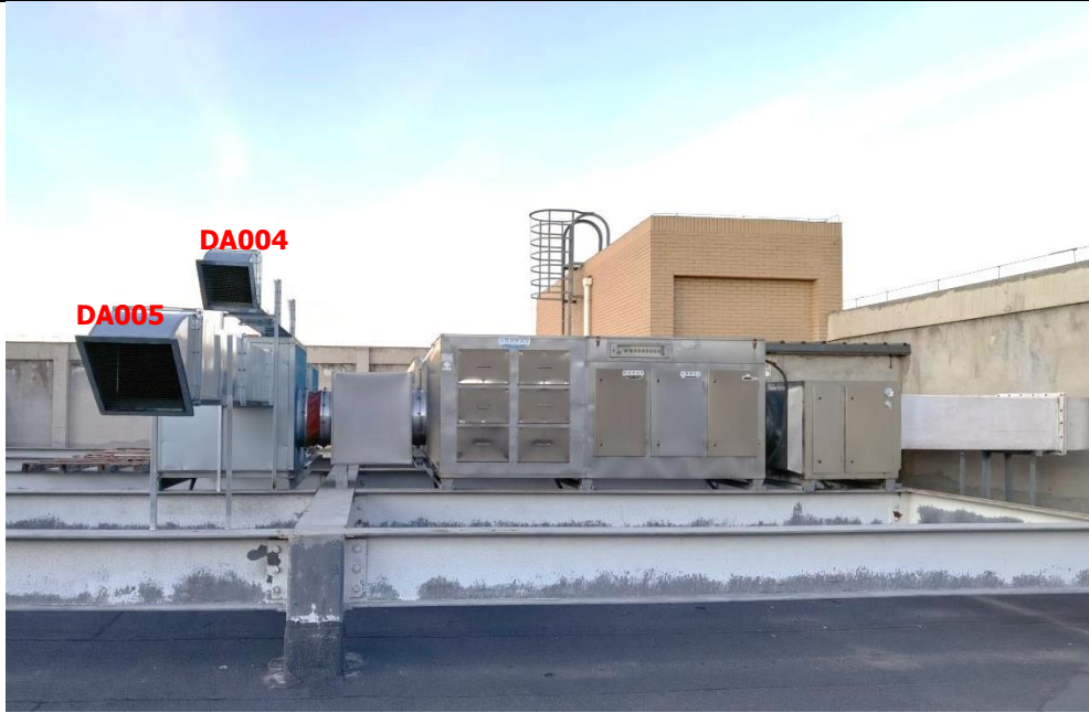
图3-8 实验室废气净化及排气口
