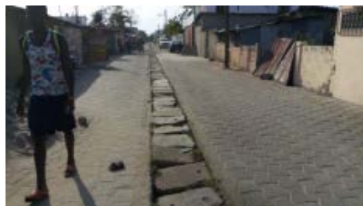
Rue 12.180 : Etat des dalles et des feuilles du caniveau
