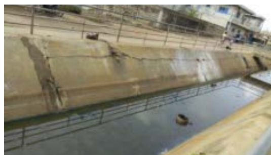
Canal Ta : Présence de Fissures le long du canal
