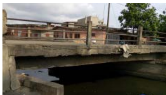
Canal A bis : Etat de la passerelle en BA (rue 6.032)
