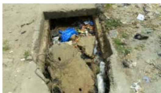
Caniveau non curé, dalles cassées
