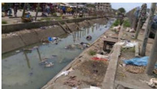
Canal B : Fissuration et affaissement des parois le long du canal sur la rue 6.020
