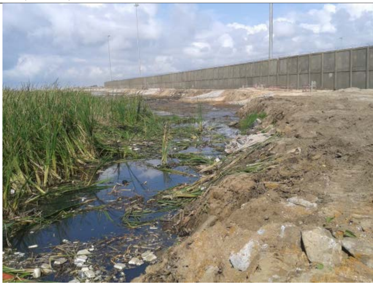
PHOTOTHEQUE D'UN EXEMPLE DE BASSIN DE RETENTION REALISE DANS LA ZONE SUD DE LA BANDE DES 300M (COTE PLAGE) DANS L'ENCEINTE DU PORT DE COTONOU
