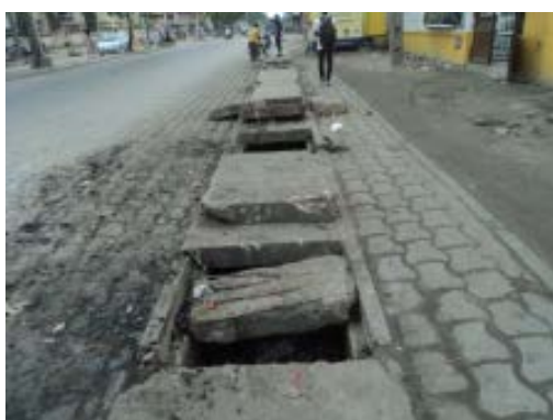
Enrobage des armatures de dalles non assuré
