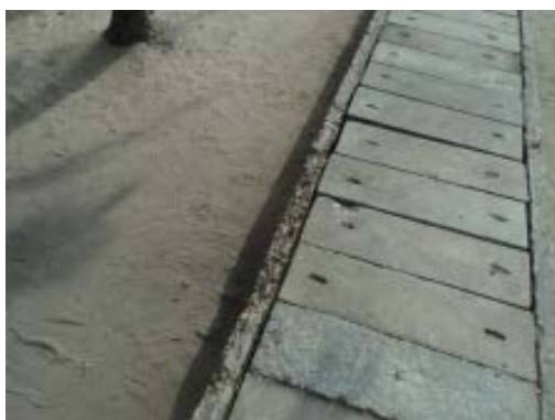
Dégradation de feuillure
