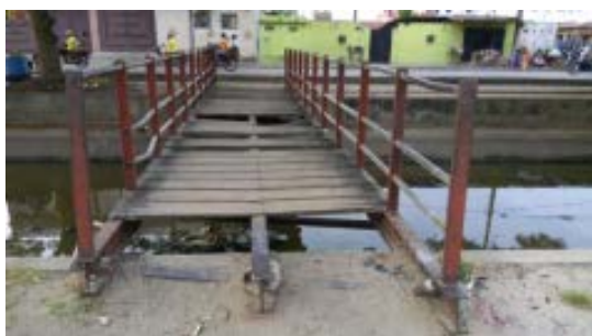
Canal A : Etat de la passerelle métallique
