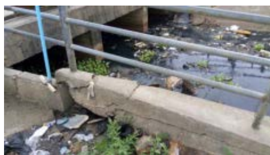
Canal Te : Affouillement au droit de paroi
