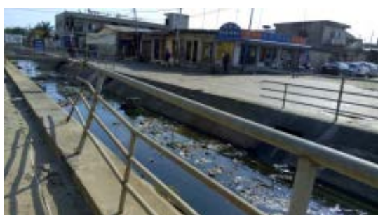
Canal Wa : Garde-corps enlevé par endroit le long du canal
