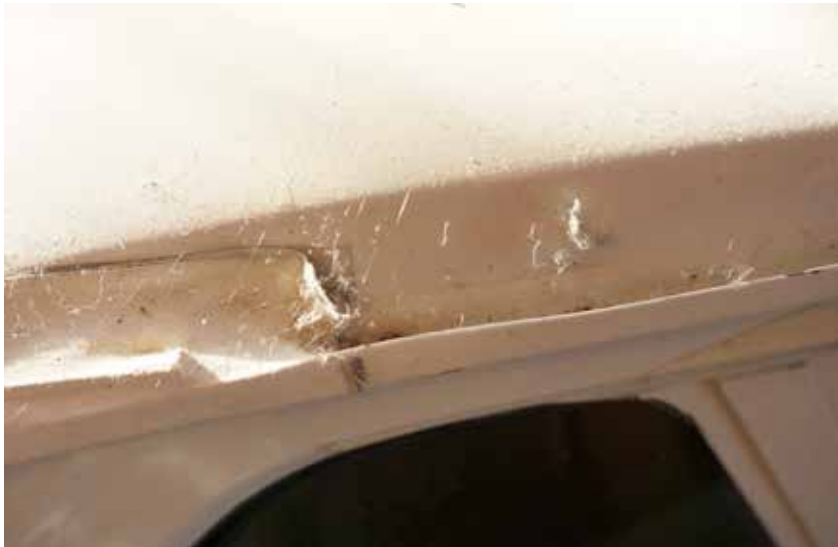
détail du toit : présence de locataires, poussières, décollement ruban adhésif.
