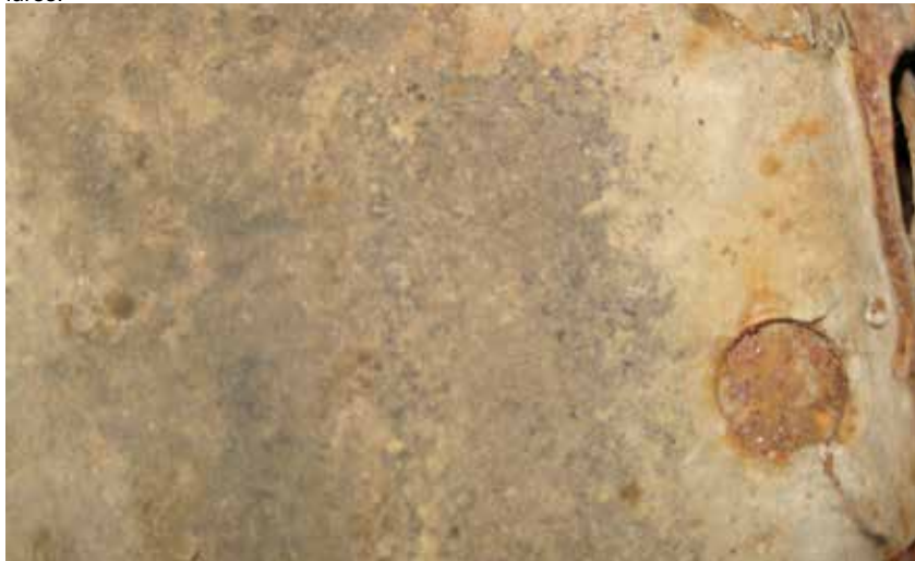
détail du soubassement : corrosion + délamination + fissure.
