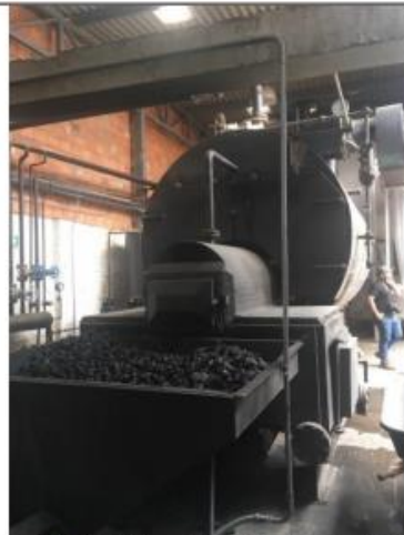
Fotografía 2. Caldera Power Master de 100 BHP
