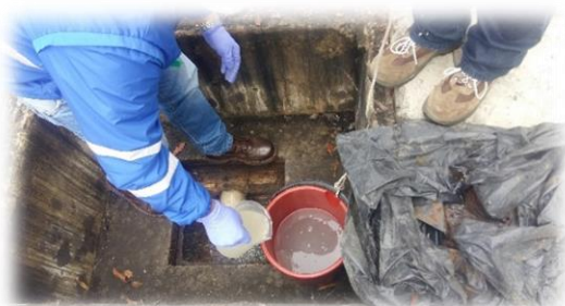
Foto 1. Caja de inspección externa Pesquera Jaramillo
