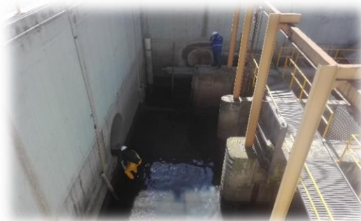
Foto 2. Estación elevadora San Benito
