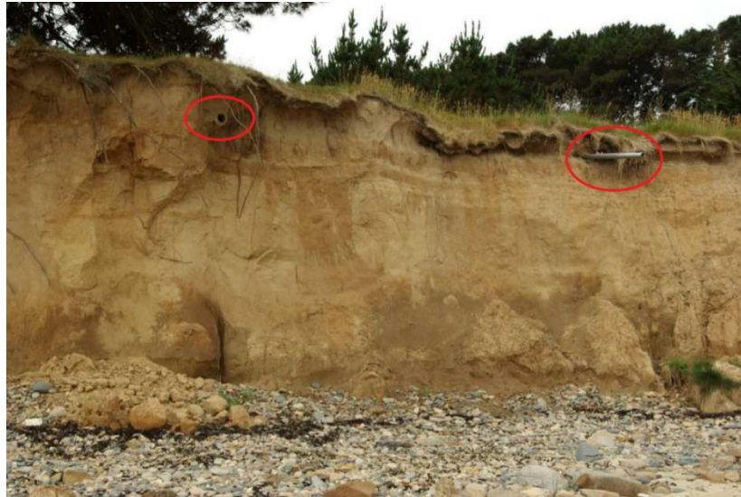
Figure 10 : 2 évacuations d'eaux pluviales et/ou d'assainissement venant des habitations dans la partie centrale.
