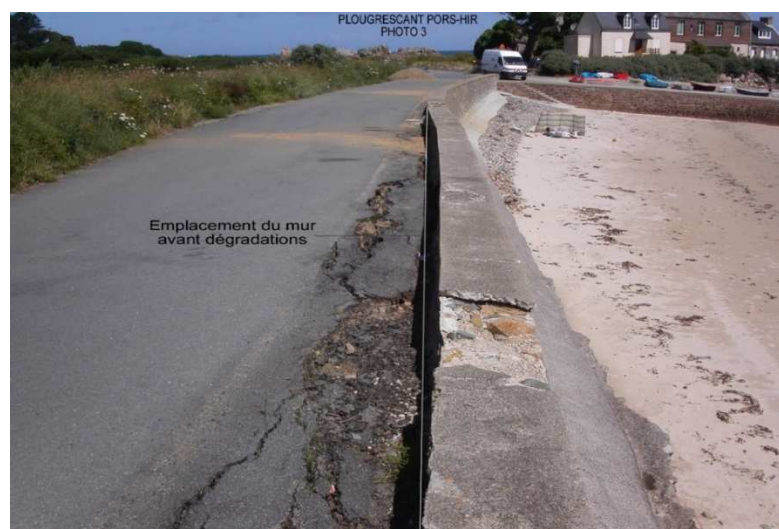
Figure 11 : Fissure et décalage du mur suite aux aléas.
