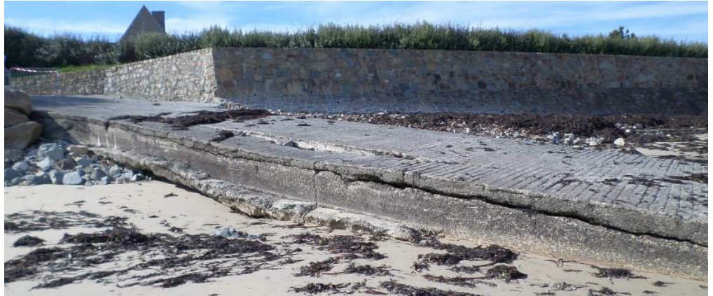
Figure 18 : La petite cale après la grande marée de février 2015. On peut apercevoir un trou au milieu de la cale, des fissures mais aussi que la mer a réussi à ronger le dessous de la cale. (Source : Le Quellec Kenan)
