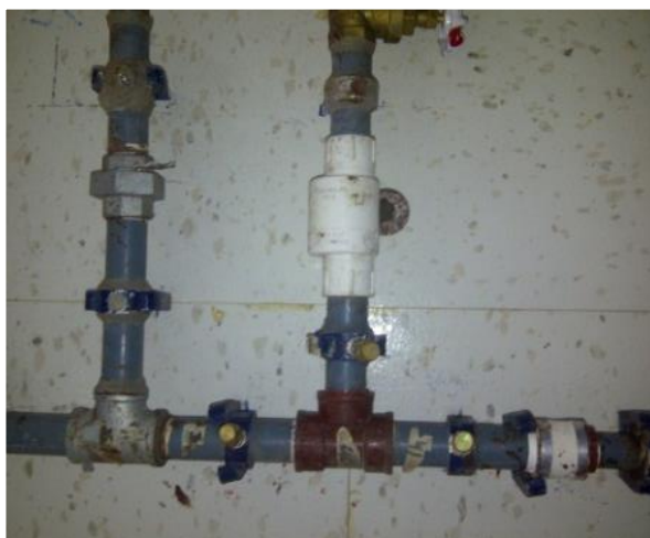
Figura 41. Accesorios en mal estado
